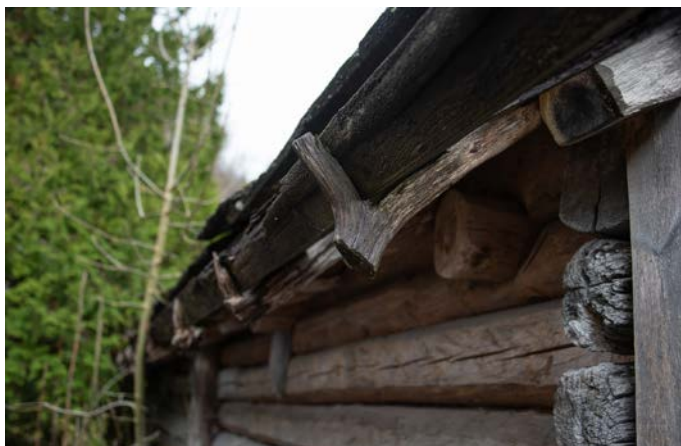
Over: Naturleg vaksne takrennefeste på naust i Laupsaffjora.
