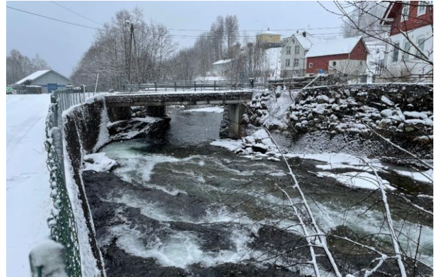
B) Forhold ved Sjusetevegen bru ved «normal» vannføring, steinhylle under bru på venstre side og utrasing av tørrmur på høyre side (sett medstrøms).
