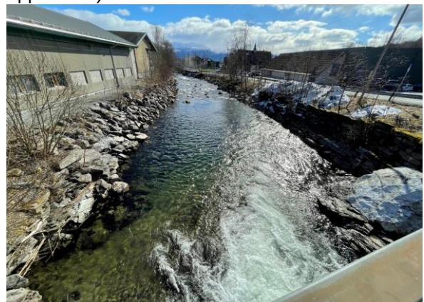
F) Forhold nedstrøms Holmane bru – utsikt mot nedstrøms. Tørrmur på vestsiden, med utrasing ca. 15 m nedstrøms brua. Steinsikring på østsiden (sett medstrøms).
