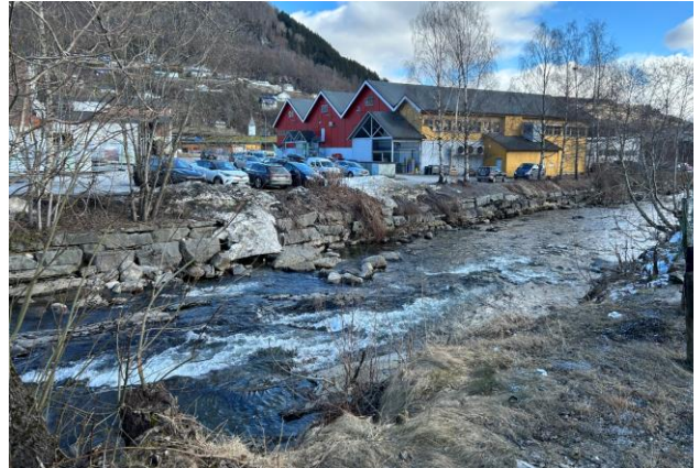
B) Oppstrøms Sjusetevegen 6. Tørrmur med noe utrasing (sett medstrøms).
