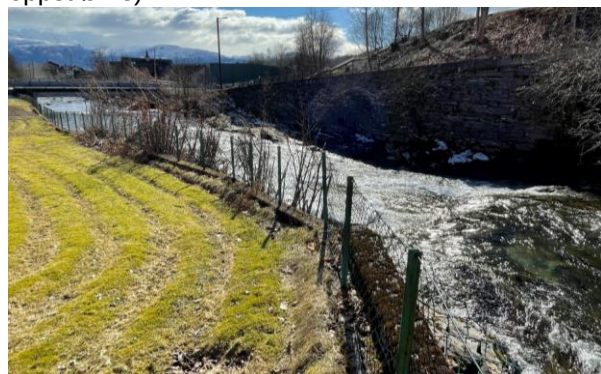
F) Utsikt nedstrøms mot Holmane bru fra østsiden av elva. Vestsiden av elva består av en høy tørrmur (sett medstrøms).
