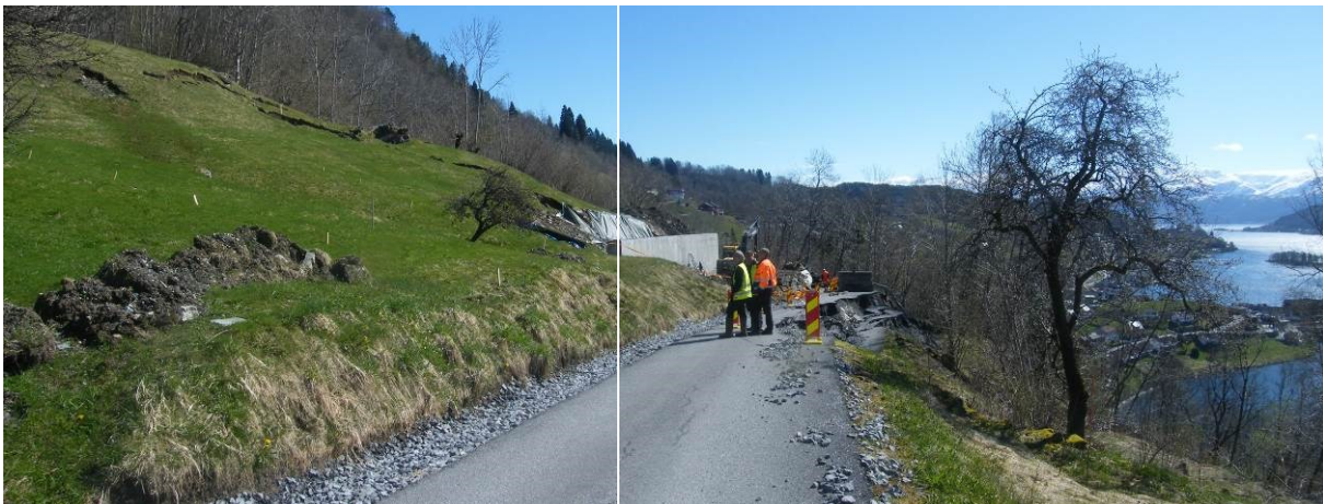
Figur 10. Jordseg ved Skutlaberg, som starta i oktober 2014, har litt og litt øydela den kommunale vegen til Skutlaberg. Den 27. apr. sprakk det òg opp på oppsida av vegen. Kvam herad jobbar med å lage ny veg.
